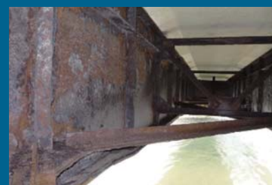
未点検の橋梁桁間では、環境により腐食が進行している場合があります。
