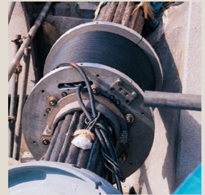
太径ケーブルの測定例
