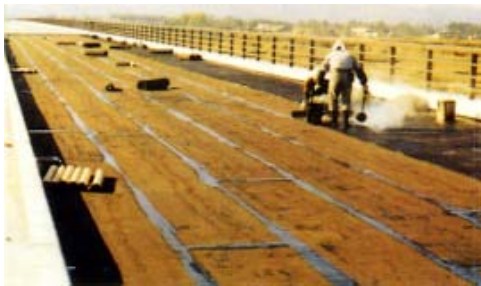
防水シートの張付け(張付け用アスファルトによる流し張り)
