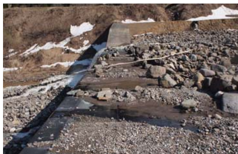
▲ラバーSteel設置状況 (平均摩耗速度0.26mm/年、経過年数18年時)
