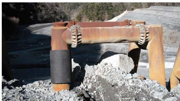
▲山梨県 御池ノ沢(鋼製スリット)
