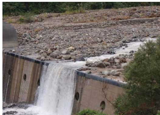
▲ラバーSteel設置あり(経過年数18年) (位置：左記砂防堰堤の上流) 下流のコンクリート製砂防堰堤が、10年で最大約10mの摩耗を受ける環境下でもラバーSteelは健全に機能しています。
