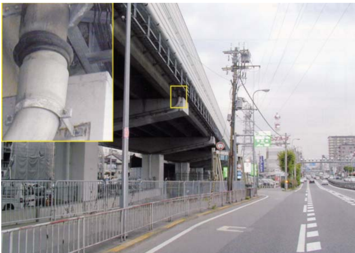
昭和 54 年 (1979 年) に阪神高速道路 15 号堺線に取り付けられた「φ200A 型」です。阪神大震災を経た現 (2002 年) でも完全な機能を維持しています。
