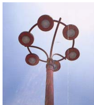
吾妻橋 シンボル照明
